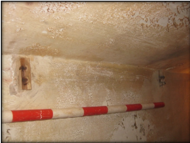
FOTO 9. Detall dels suports del cablejat elèctric.
